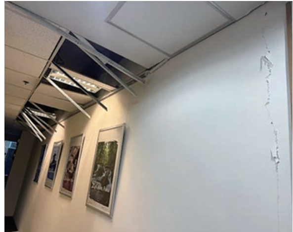
弊所でも天井パネルの落下や、壁に亀裂が入るなどの損傷が発生
